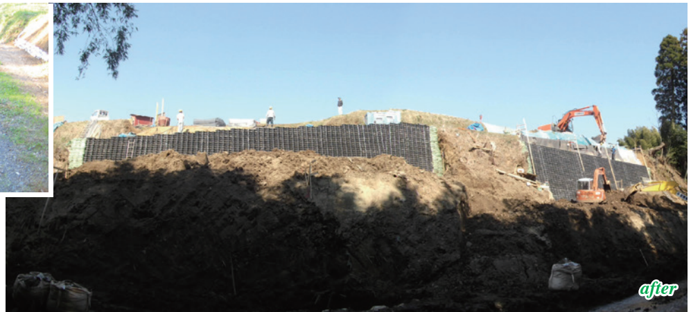
施主：千葉県勝浦市役所 / 工事名：小羽戸地区災害復旧工事 ■ 壁面勾配：1：0.3 ■ 壁高：6.75m ■ 壁面積：240㎡
