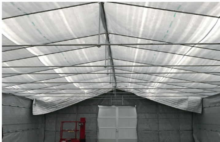
▲内張り施工中 農 PO 固定張りの上にエネルギーキーパー DW を展張
